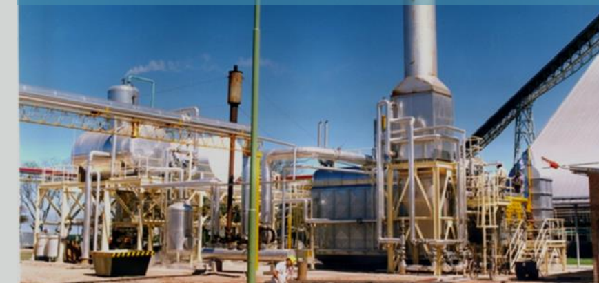
CAPTAÇÃO E TRATAMENTO DE ÁGUA E GERAÇÃO DE VAPOR LA PLATA CEREAL PUERTO SAN MARTIN, ARGENTINA
